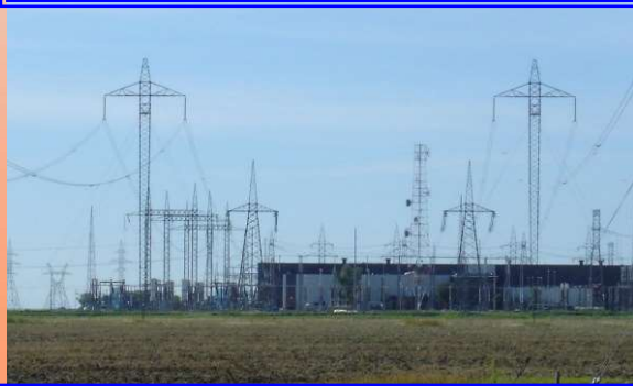
高壓直流輸電(加拿大納爾遜水電站)
