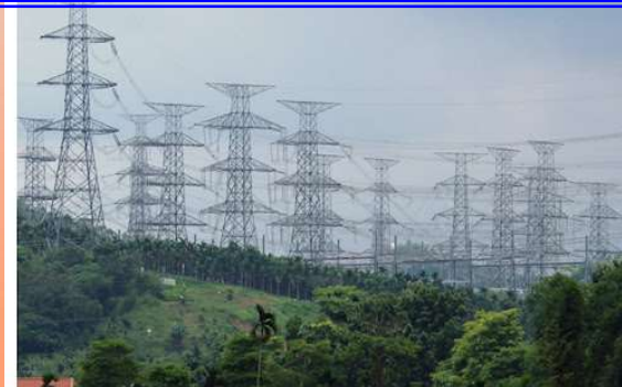
南投 中寮變電所
